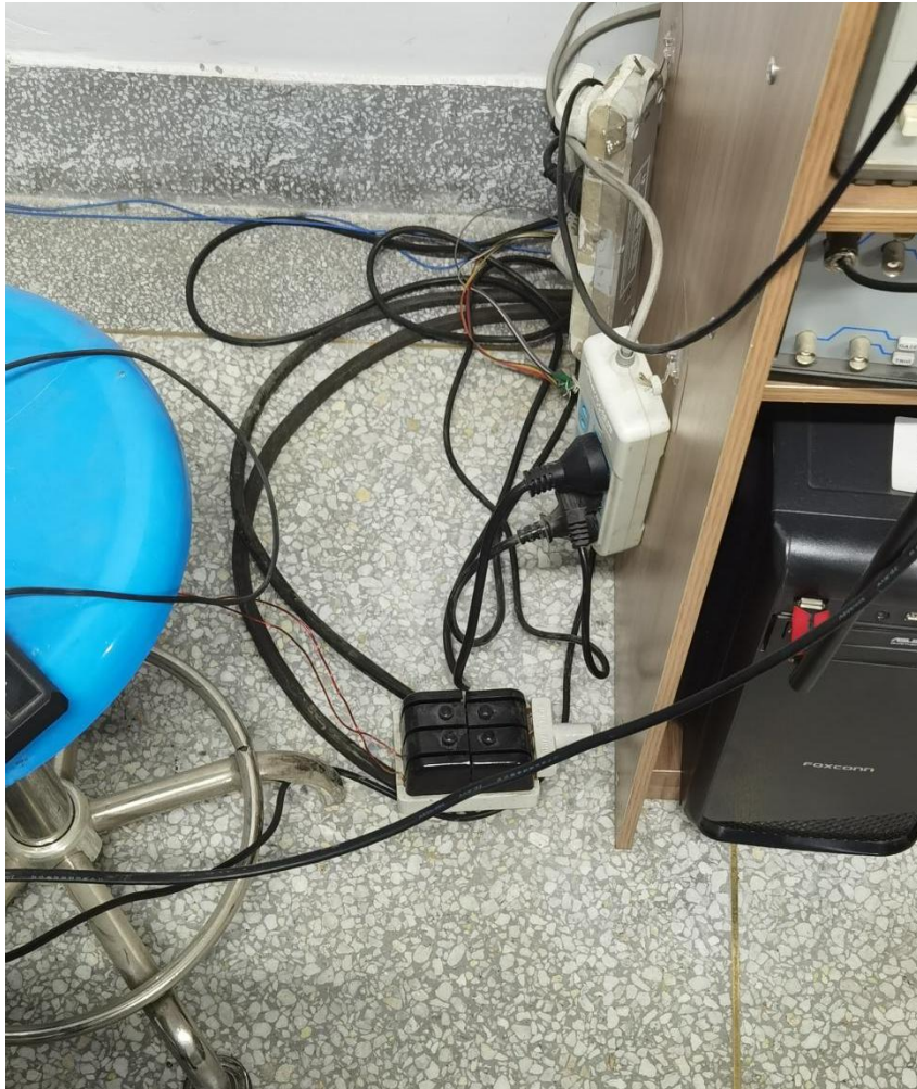
六、理工楼 1427：配电柜门前堆放杂物、卫生杂乱
