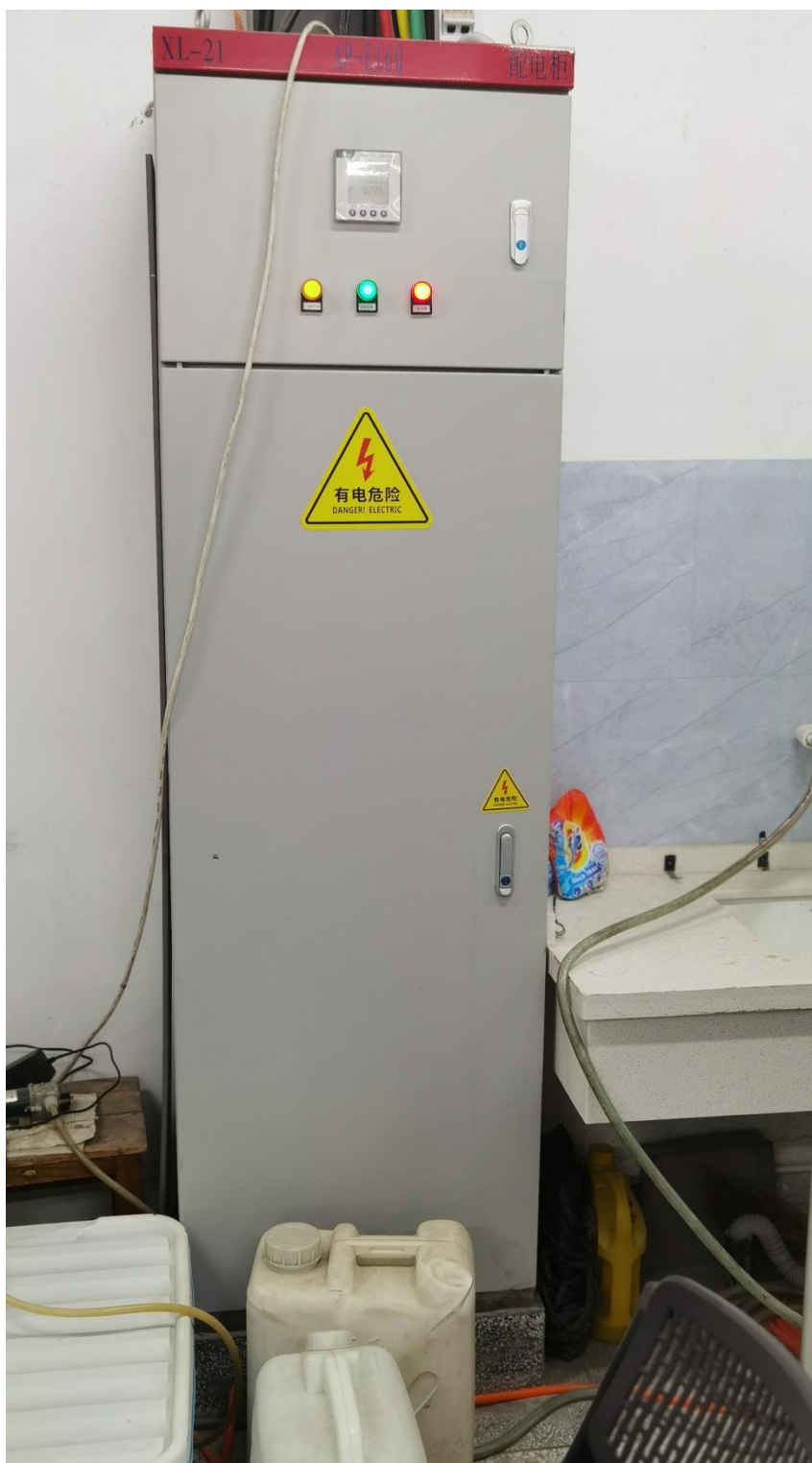
五、理工楼 123: 电闸放在地上
