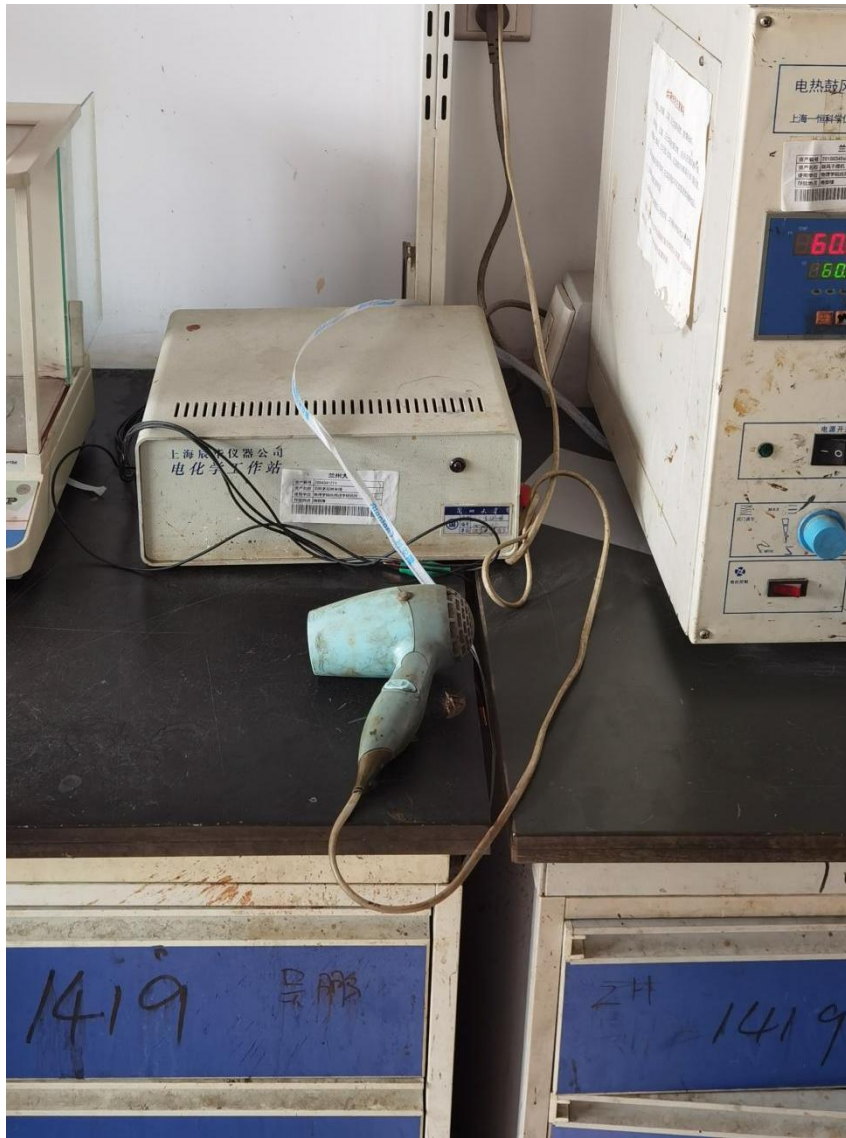
十一、理工楼 1411：化学废药品堆放未及时处理、配电柜顶堆放化学药品已造成腐蚀
