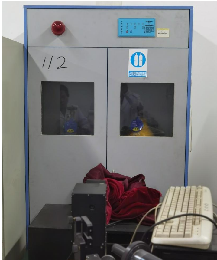
二、理工楼 118 房间：插线板放在地上
