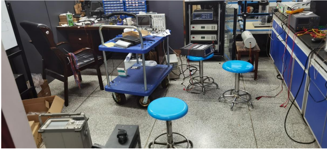
四、理工楼 117：配电柜门前堆放杂物，配电柜顶放电线
